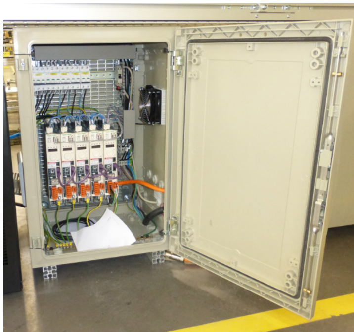
Vue de l'armoire de commande
